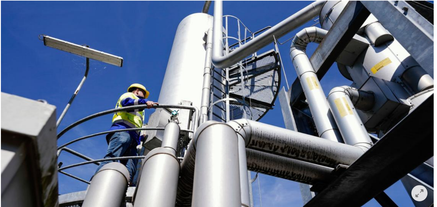
Ein Gasspeicher in Rheinland-Pfalz
